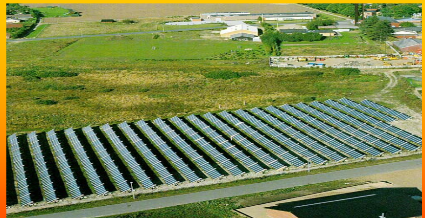
1300 domaćinstava u jednom gradiću u Danskoj grije se sistemom daljinskog grijanja pomoću sunčevog kolektora površine 3000 m 2 . Pored toga koristi i otpadnu toplotu iz gradske termoelektrane
