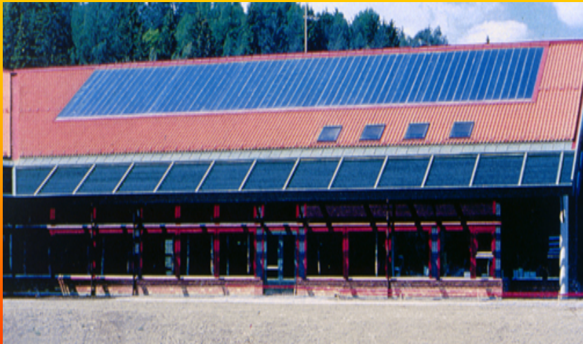
Novi solarni energetski sistem – “Solarni energetski krov” – je ugrađen u krovnu konstrukciju jednog sportskog centra u Norveškoj. Postavljen je 1994. i grije dva bazena.
